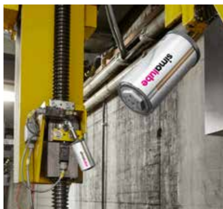
De spindels van een hefstation voor treinwaggen en locomotieven worden met simalube 125 ml patronen gesmeerd gedurende 12 maanden.
