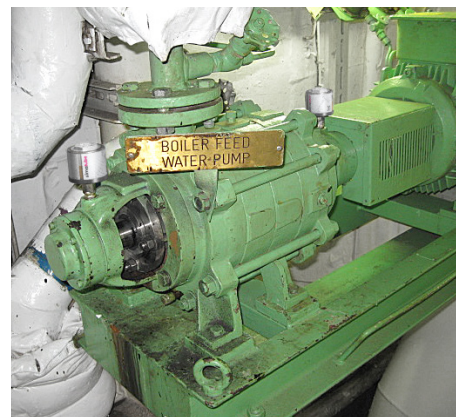
simalube 30 ml zijn gemonteerd op de waterpompen van een boiler.
