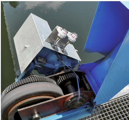
Lagersmering via slangen bij een nabezinker.
