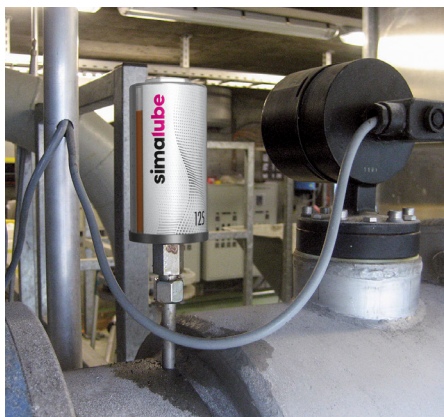
Lagersmering: het smeermiddel wordt met een stalen leiding naar het lager getransporteerd.
