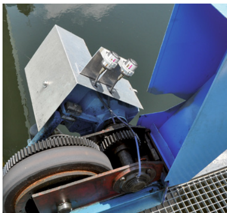
Graissage de palier via des tuyaux sur un décanteur secondaire.
