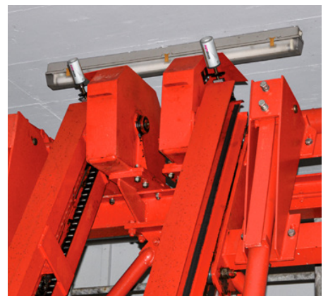
Lubrification de chaînes avec simalube, sur une grosse grille équipée de brosses.
