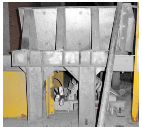
Plusieurs graisseurs simalube de 125 ml lubrifient le transporteur par vibration.
