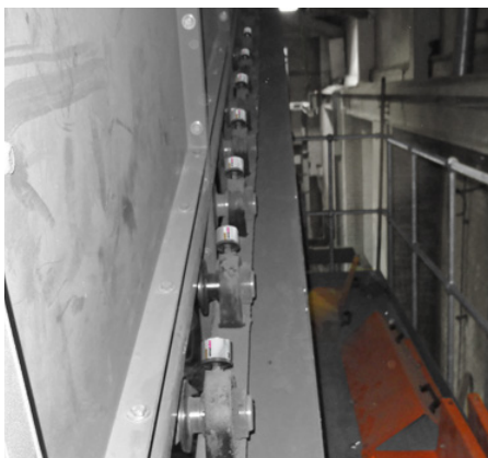
Des dizaines de graisseurs simalube de 30 ml lubrifient les roulements d'un tapis roulant.
