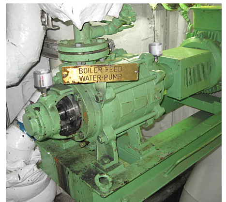
simulube 30ml sind auf der Wasserpumpe des Dampfkessels installiert.
